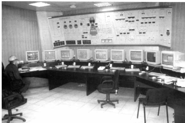
Centralna sterownia wielkiego pieca nr 5
