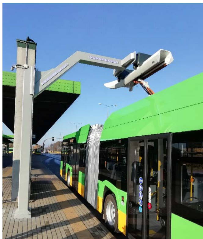
Zdjęcie 1. Pantograf na pętli autobusowej MPK Poznań
