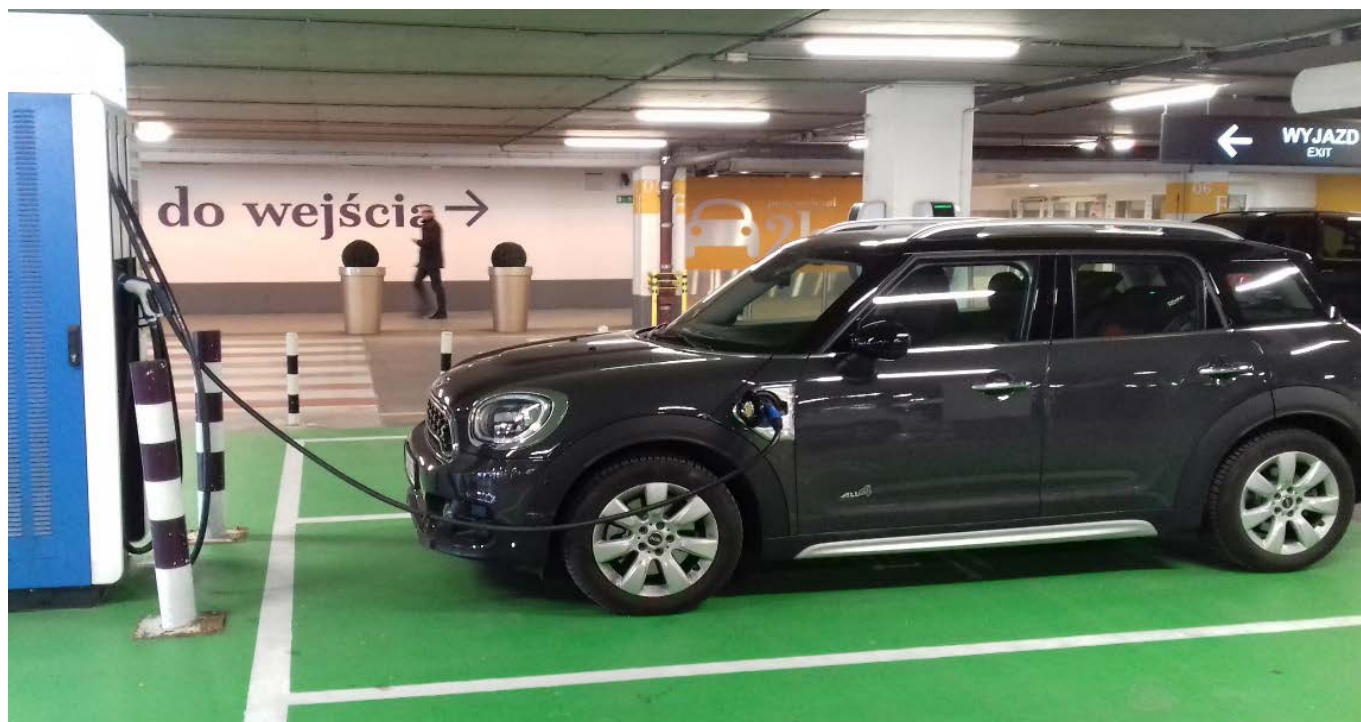
Zdjęcie 2. Stacja ładowania na parkingu galerii handlowej
